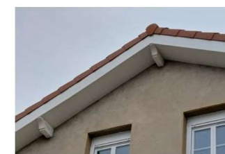
X Habillage du débord de toit en PVC
