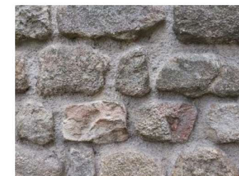
✗ Joints ciment en creux
