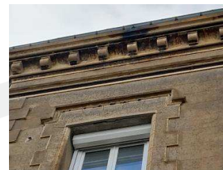
Corniche en ciment prompt
