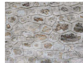
✗ Joints au ciment artificiel au nu du parement, gravure d'un faux joint dessinant un appareillage polygonal.
